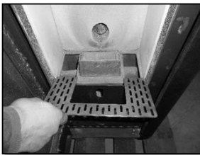
Figura 30 – Remoção da grelha de cinzas
